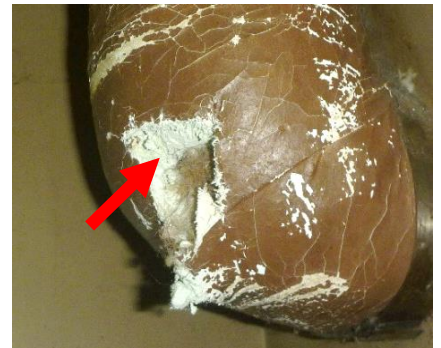
保温材の露出
